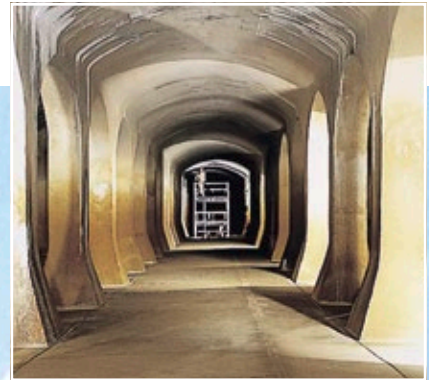
Trinkwasserspeicher, Köln, Deutschland
